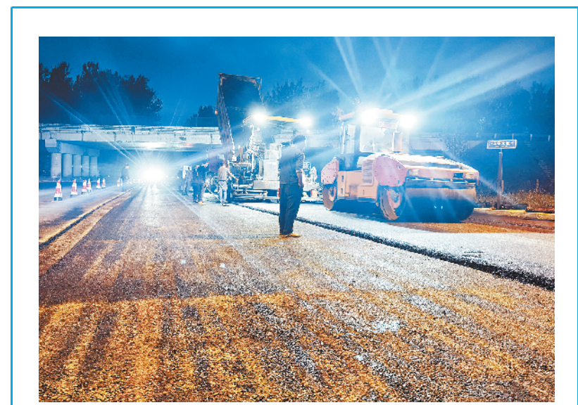
近日,经过淮阳区公路局20多天的紧张作业,G344线淮阳境内下穿商南高速高架桥里程桩号K703+669处降低了路面高度,提高了净空空间,彻底消除了车辆通过商南高速桥底时的安全隐患,保障了行车安全畅通。
