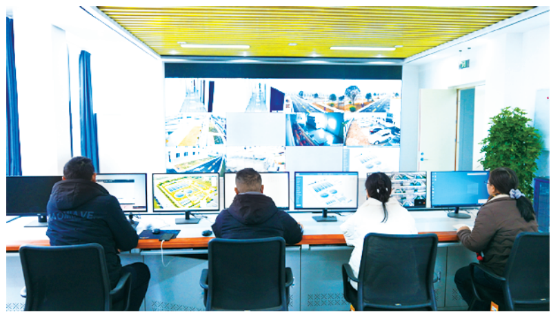
图为市第二污水处理厂监控指挥中心。
