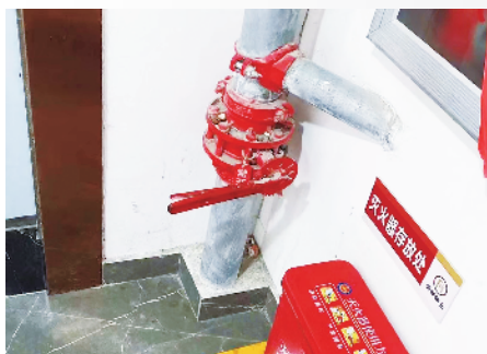
消防栓管道蝶阀关闭。
